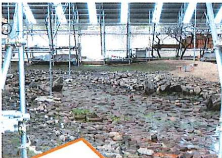
ただ今庭園内を修復工事されております。写っているのは池の部分です。
